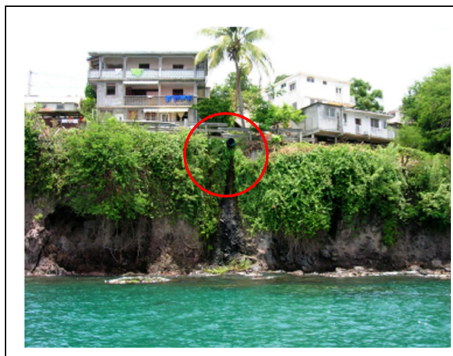
Photo 3. Buse de rejet des eaux usées et pluviales sans traitement
