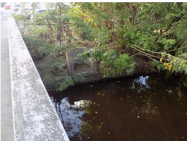
Exutoire d'eaux pluviales dans la ravine
