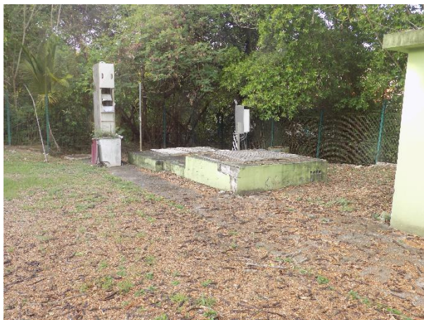
Figure 61 : Poste de refoulement de l'Anse à l'Ane
