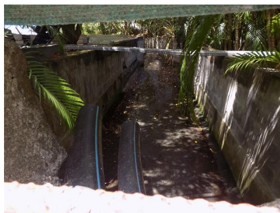
Exutoires d'eaux pluviales importants avec écoulement par temps sec
